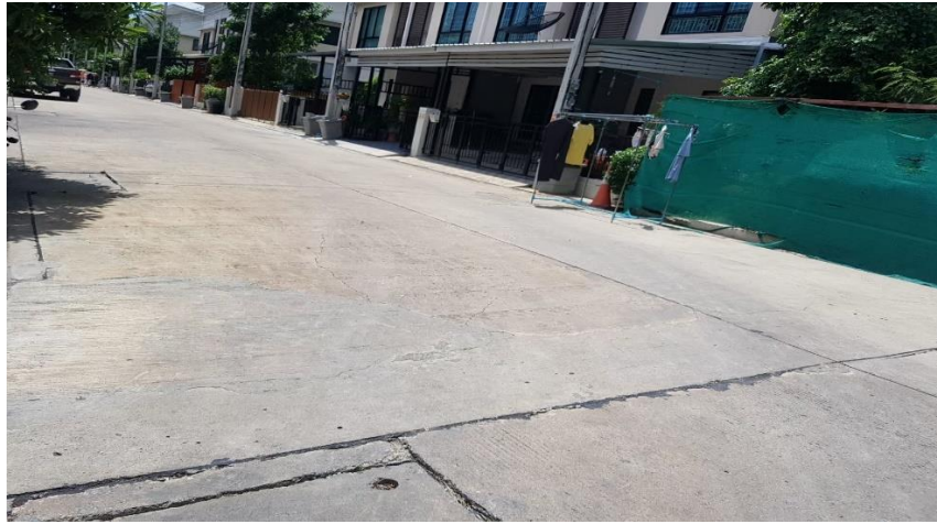
ภาพที่ 3-9 ลักษณะงานถนนผิวคอนกรีตแตกร้าว
