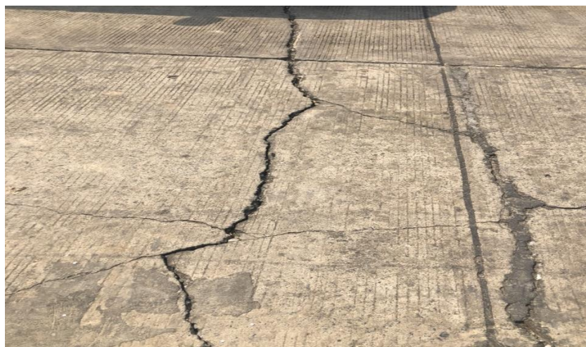
ภาพที่ 3-11 ลักษณะงานถนนคอนกรีตที่แตกร้าวแนวขวาง
