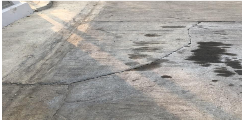
ภาพที่ 3-10 ลักษณะงานถนนคอนกรีตทรุดตัว
